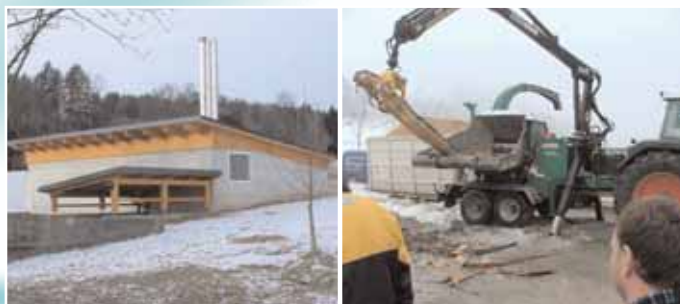
links: Heizhaus mit der 10 kW Kaltgasturbine und der 250 kW Heizung zur Versorgung der LFS Stainz rechts: Hackschnitzelerzeugung als Grundlage der Strom- und Wärmelieferung
